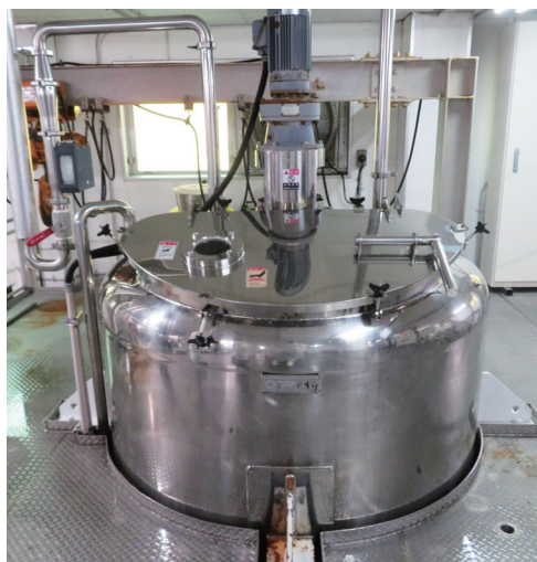
内容物の混合、攪拌を行うタンク
